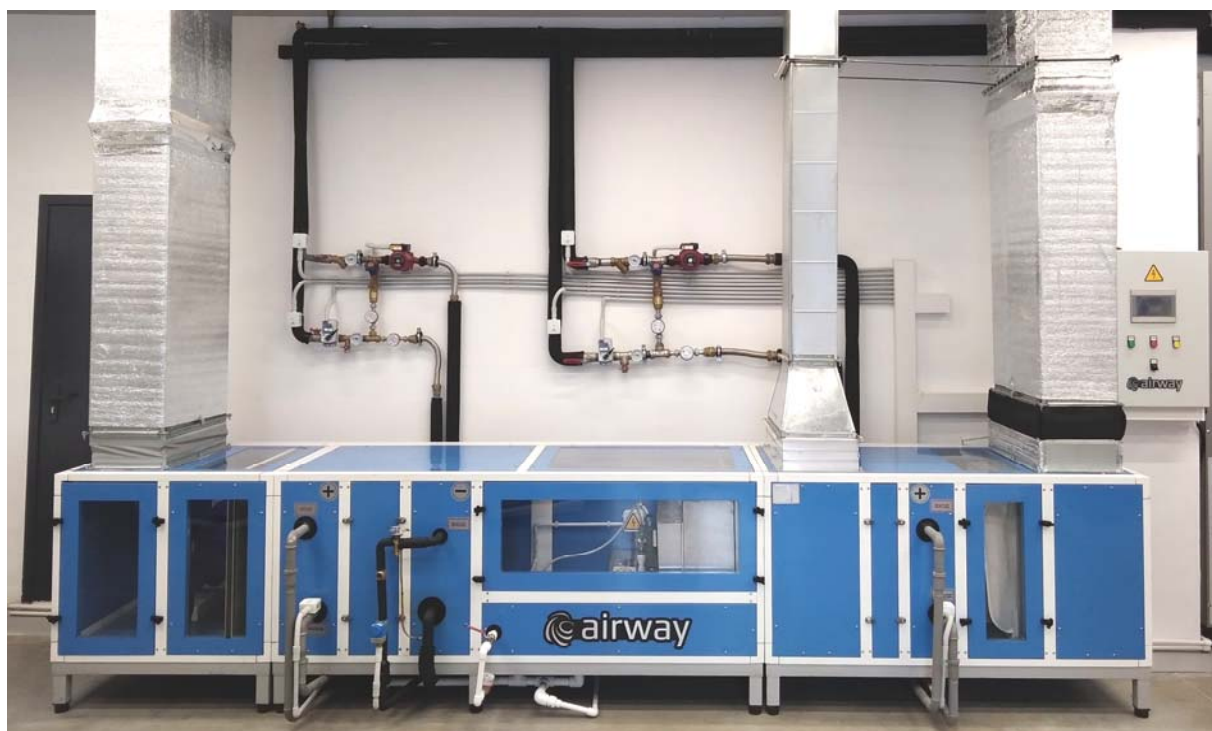
Рис. 3.7. Центральный кондиционер в Центре «SYSTEMS»
