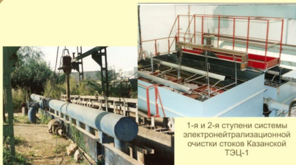
Установка очистки ливневых стоков ОАО КМПО от нефтепродуктов и взвешенных веществ методом электронейтрализации
